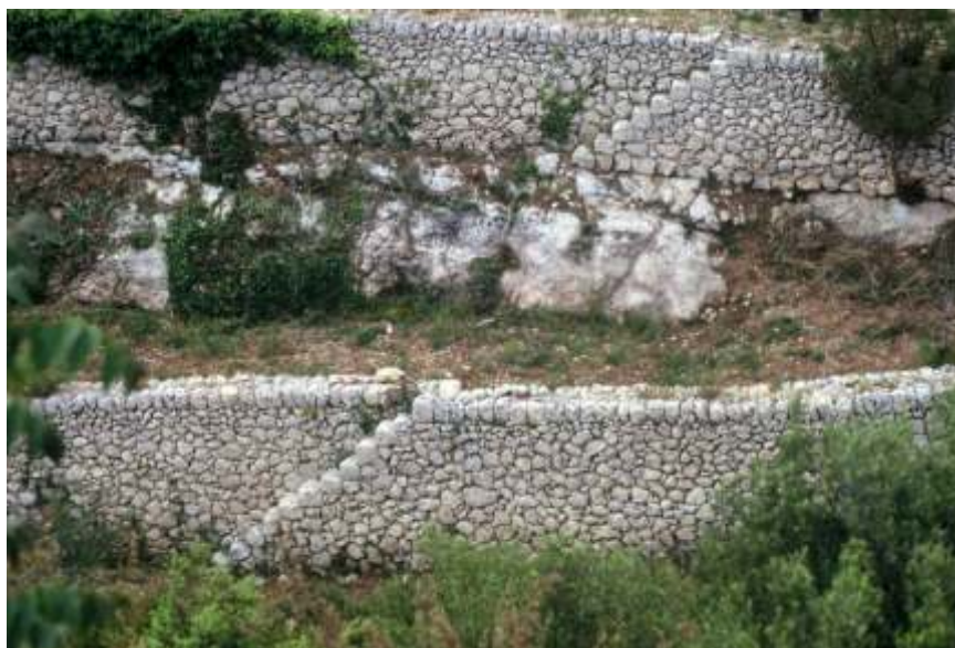
San Corrado Fuori Mura - Effondrements
